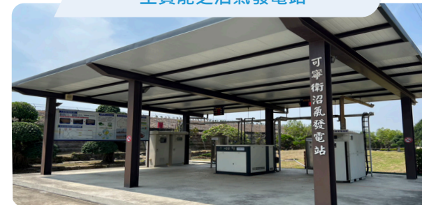
生質能之沼氣發電站
