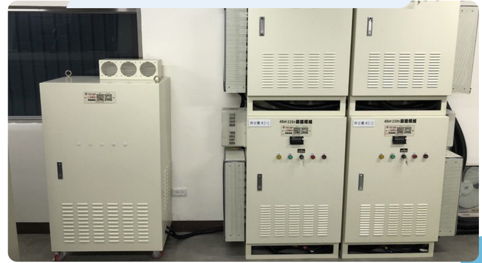
固化廠使用的節能變頻模組
